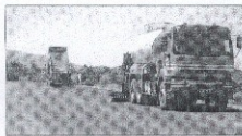
La société Colas, sous-traitant de l'entreprise de travaux du Nord (ETN), a commencé mardi matin les travaux de revêtement bitumeux portant sur la chaussée et ses accotements.
